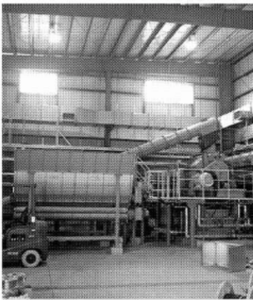
羽村バイオガス発電所は2020年7月の稼働を予定している(東京都羽村市)
