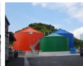
メタン発酵槽・消化液槽
